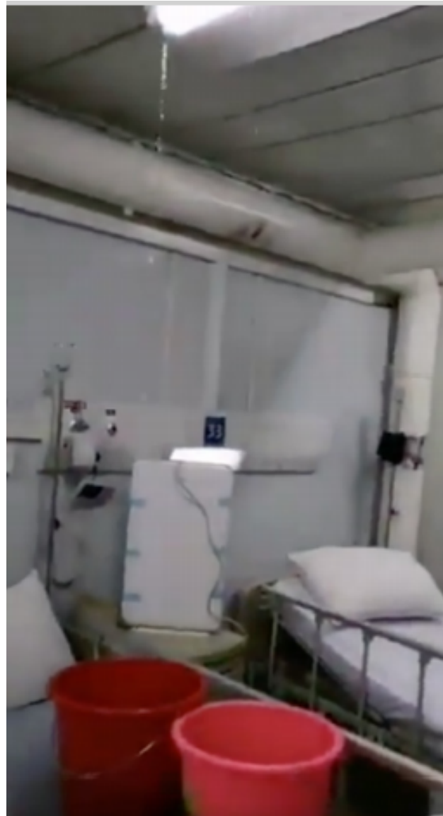
Gambar 1. Bocornya air di bangunan rumah sakit berisiko menimbulkan infeksi jamur (Sumber: Jones, 2020)
